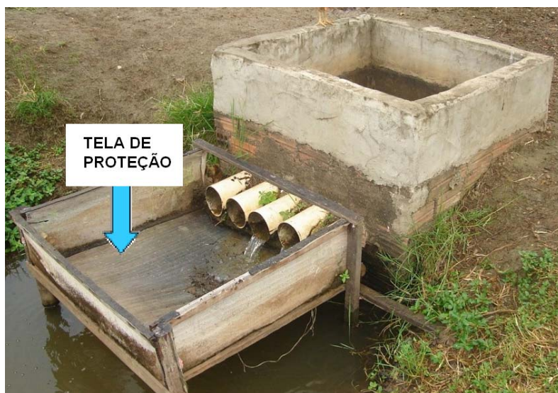
Figura 9 – Telas em caixa de passagem de água.
