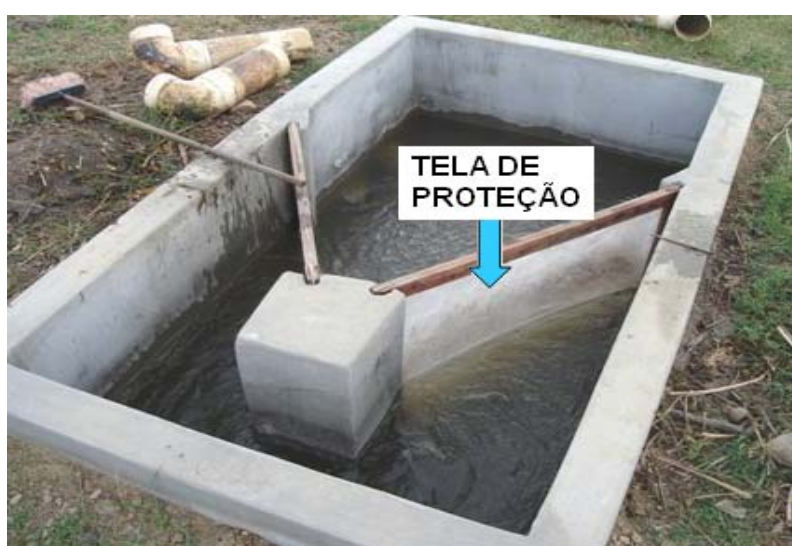
Figura 8 – Telas em caixa de passagem de água.
