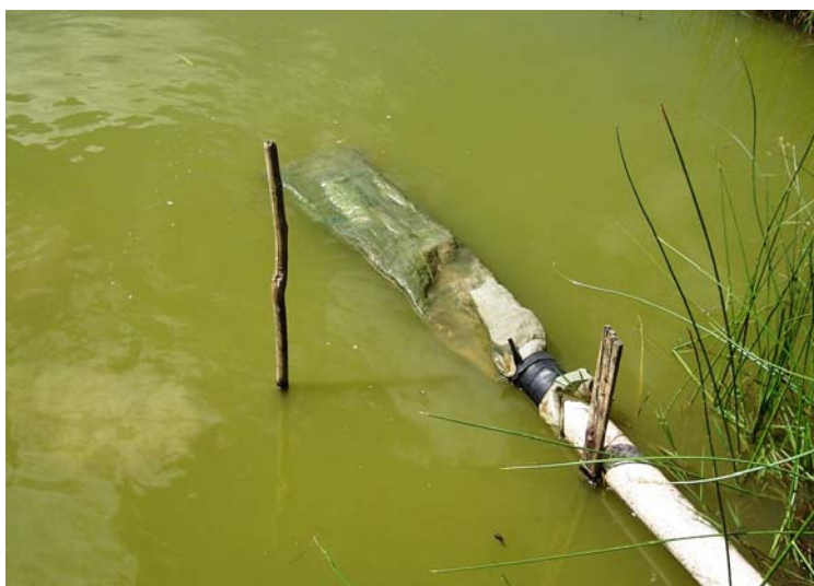
Figura 10 - Tela de proteção no cano de abastecimento.
